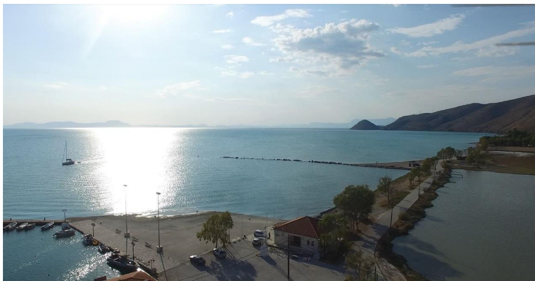
Εικόνα 6-5 Γενική άποψη προς ΒΔ του βόρειου χώρου - τραπεζοειδούς προβλήτα, τμήμα του οποίου έχει υποστεί καθίζηση και δεν είναι λειτουργικό-διακρίνεται και ο υφιστάμενος λιμενικός σταθμός (λήψη από drone Σεπτ. 2020)
