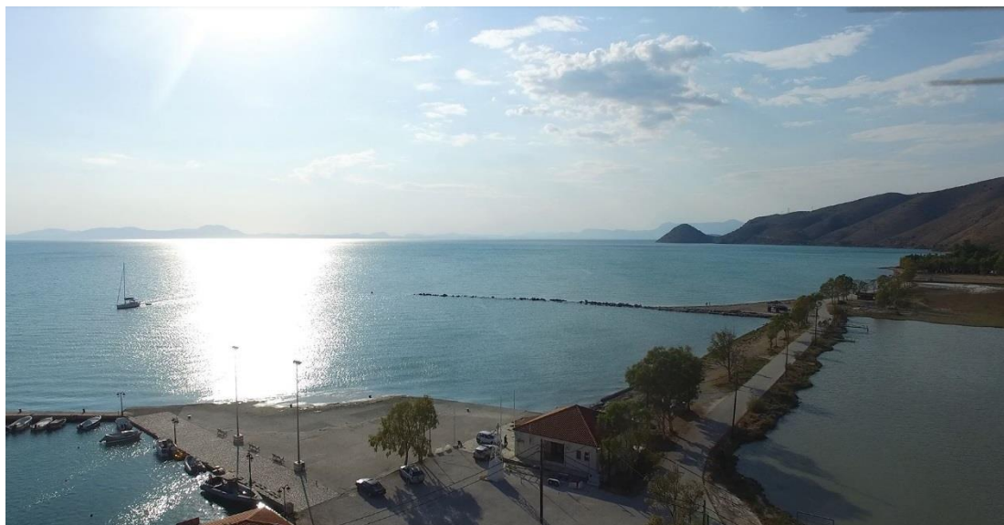
Εικόνα 2-4 Γενική άποψη προς ΒΔ του βόρειου χώρου - τραπεζοειδούς προβλήτα, τμήμα του οποίου έχει υποστεί καθίζηση και δεν είναι λειτουργικό-διακρίνεται και ο υφιστάμενος λιμενικός σταθμός (λήψη από drone Σεπτ. 2020)
